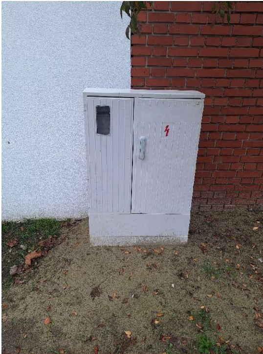
Slika : Postojeći SPMO ormar
