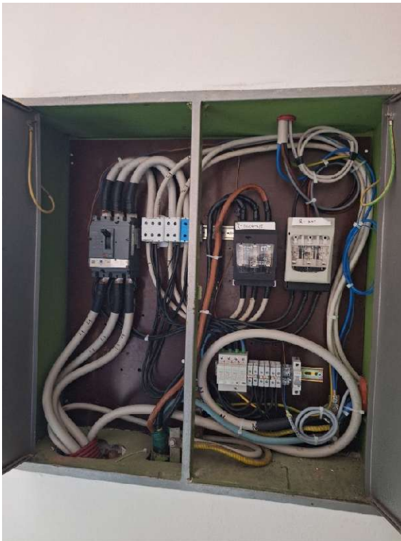
Slika : Postojeći GRO ormar
